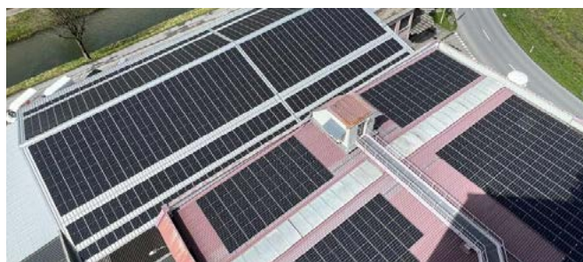
Site de production à Sennwald
